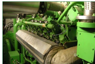
Gasmotor eines Blockheizkraftwerks – mit freundlicher Genehmigung der GE Jenbacher Biogasmotor Güssing
